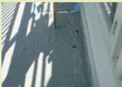
Een scheuroverbruggende coating, 12 jaar geleden aangebracht, na 4 jaar hersteld met een nieuwe coating. In 2003 opnieuw een volledige nieuwe afwerking noodzakelijk.
