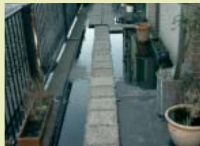
Afschotproblemen op een galerijvloer met een afwerklaag.
