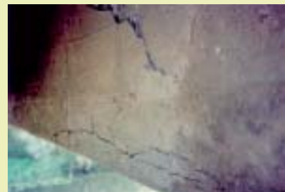
Diverse betonschades aan onderzijde hoofdliggers
