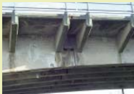
Lekkage bij de voegovergangen
