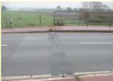
Einde levensduur asfaltverharding, voegovergangen en conserveringen
