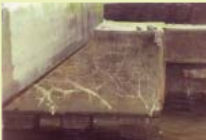
Scheuren met uitloging en desintegratie fundatieblok
