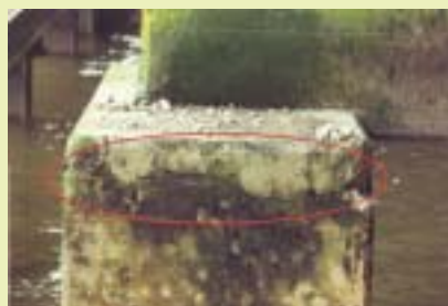
Detail scheurvorming in aangetast fundatieblok. Kop volledig afgebroken.
