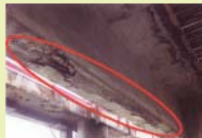
Dekkingsschade aan onderzijde draagbalk steigerdek.
