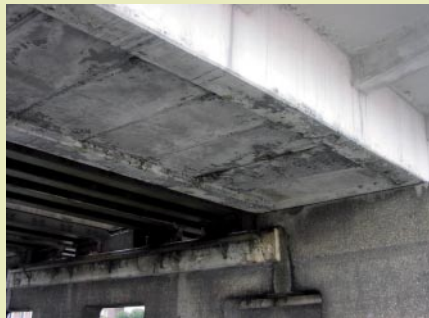
Onderzijde van het brugstation. Rechts de stalen brug voor het treinverkeer. Daarnaast de betonnen perrons.
