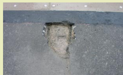
Bitumineuze verharding is boven een dwarsbalk deels weggehakt. Doorgaande scheurvorming is zichtbaar.
