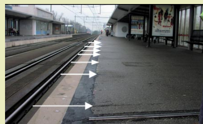
Aftekening doorgaande scheuren in de bitumineus gebonden verharding ter plaatse van de (dwars)balken
